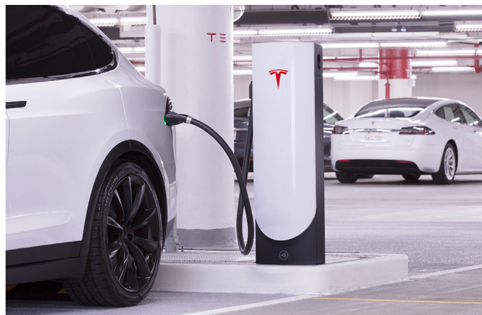
Nabíjecí stanice pro elektromobily
